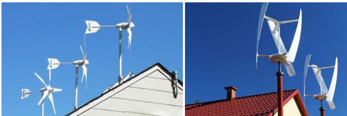
Rysunek 8. Przykłady małych turbin wiatrowych. Po prawej z poziomą osią obrotu, po lewej z pionową osią obrotu Źródło: Poradnik Małej Energetyki Wiatrowej, K. Nalepa
