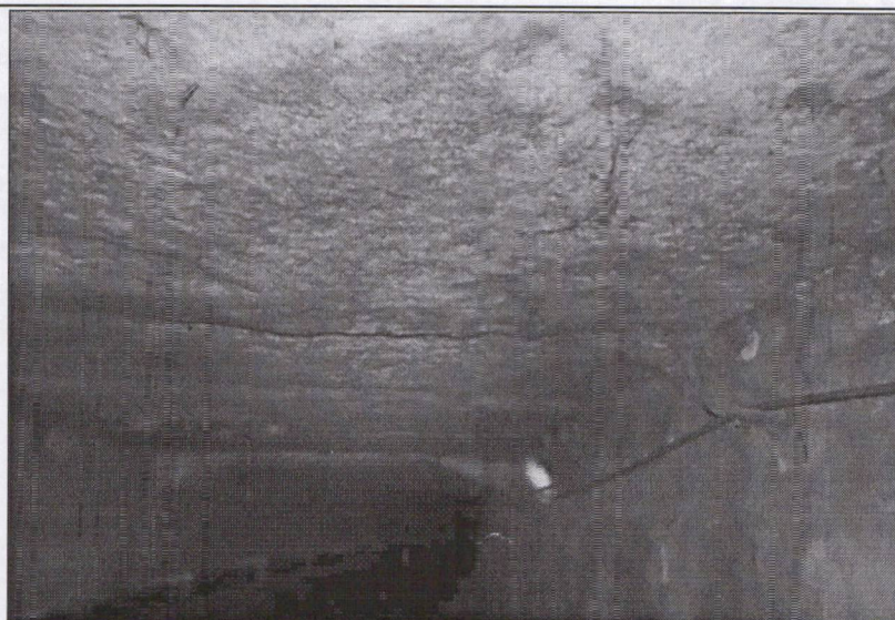
Fot. 10 Osady na sklepieniu kamiennym
