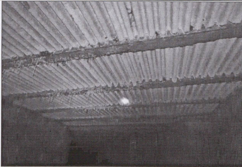
Fot. 6 Korozja dźwigara głównego oraz płyty pomostowej.
