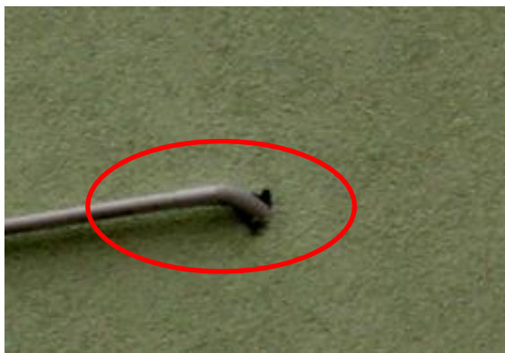
Fot. 3. Miejsce wnikania wody do szatni
