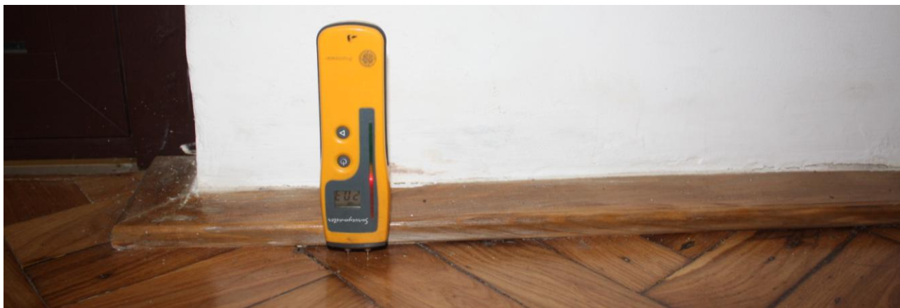
Listwa przypodłogowa i klepki parkietu przyległe do mokrej ściany są również zawilgocone
