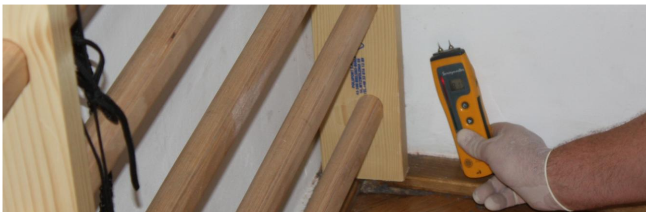
Pas ściany przy podłodze zawilgocony
