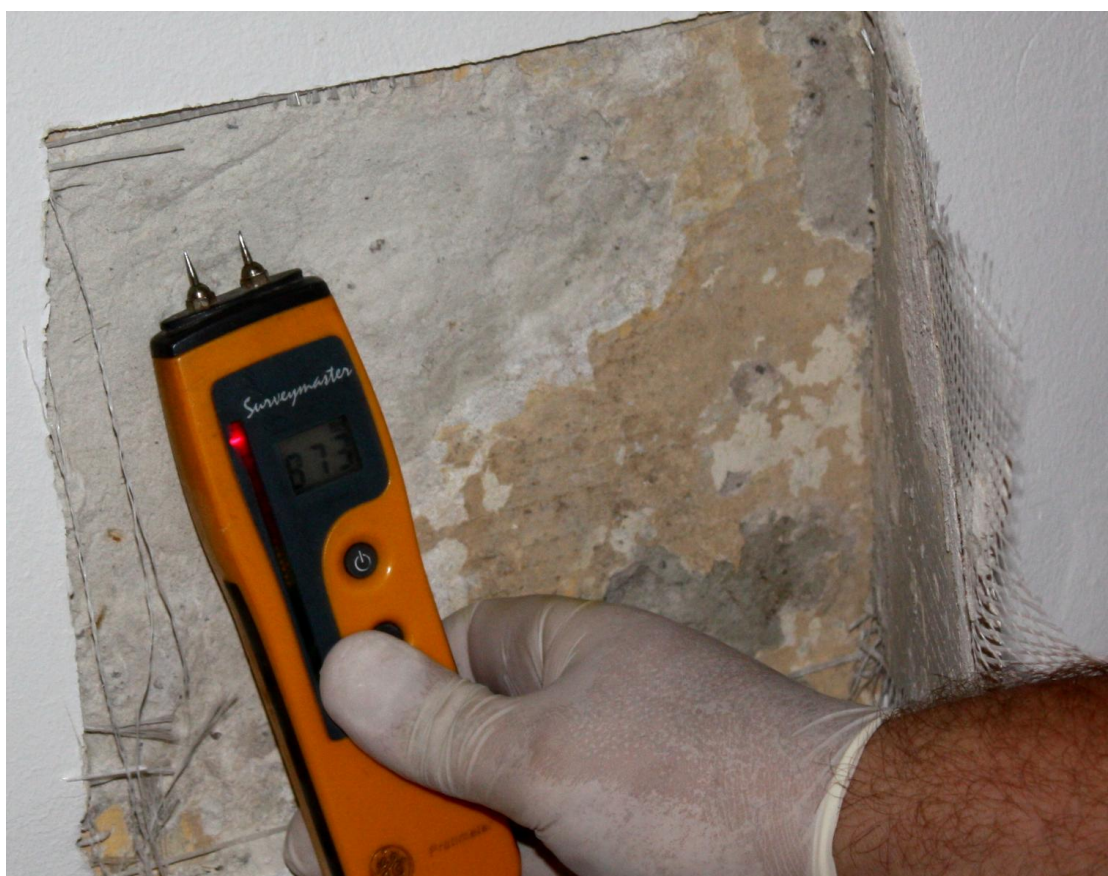
Ściana pod tynkiem mokra
