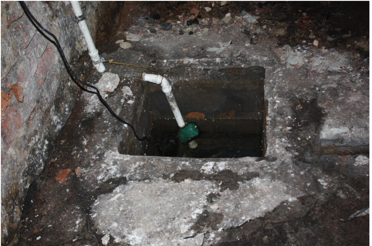
Studzienka pompowa do odpompowywania wód przedostających się do piwnicy
