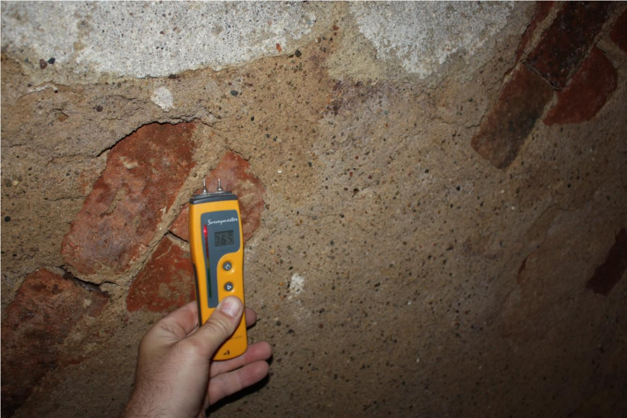
Pomiar radiowy wilgotności ścian piwnicy. Ściany mokre skorodowane, występują wysolenia.
