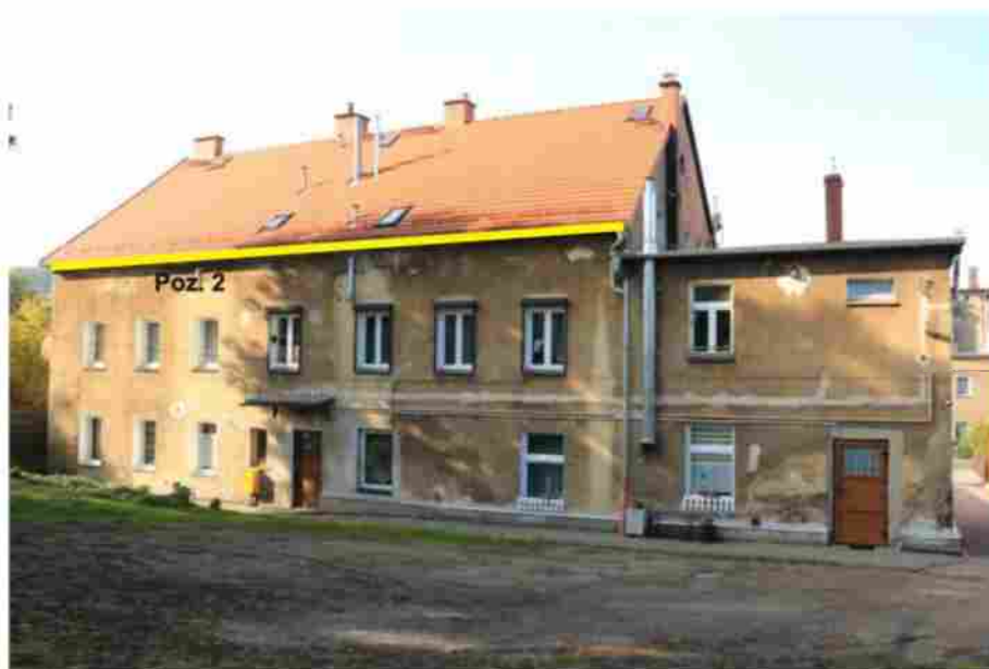
Ryc. 5. Elewacja wschodnia budynku przy ul. Równoległej 11 (wraz z przylegającym od północy mniejszym budynkiem bez poddasza) z zaznaczeniem miejsc stwierdzenia gniazd i siedlisk ptaków (żółta linia).
