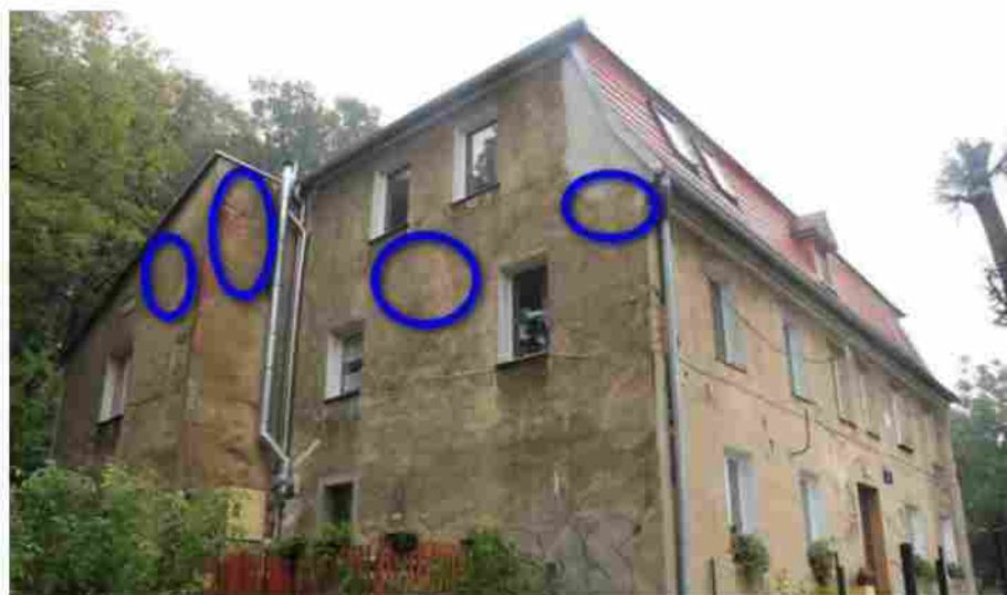
Ryc. 23. Miejsca zawieszania budek dla jerzyków na elewacji północnej budynku przy ul. Okrężnej 3, okręgi oznaczają przykładowe miejsca zawieszania budek.
