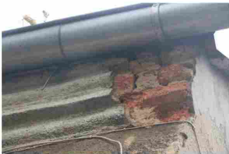
Ryc. 3. Budynek przy ul. Okrężnej 3, widok na potencjalne miejsca lęgowe ptaków w szczelinach za rynną.
