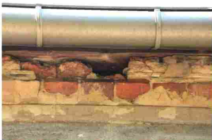
Ryc. 7. Budynek przy ul. Równoległej 11 – przykłady szczelin na łączeniu muru i dachu na elewacji wschodniej.
