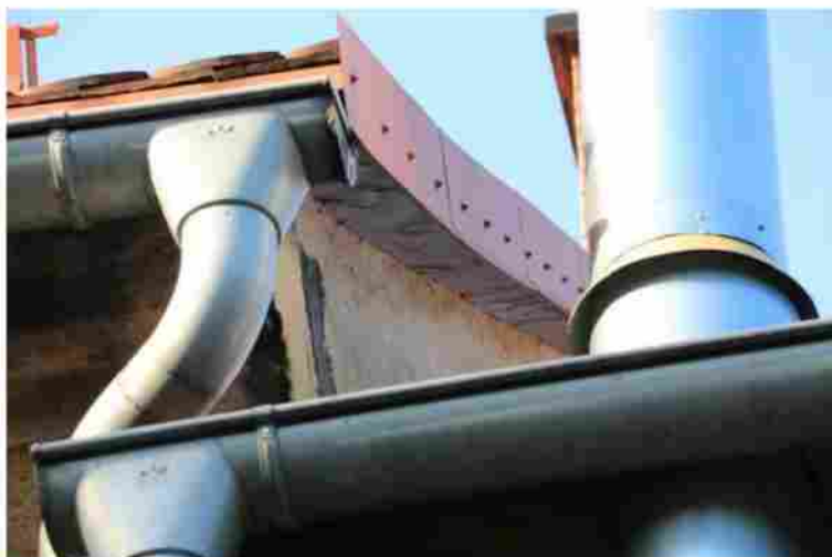
Ryc. 8. Budynek przy ul. Równoległej 11 – odnowione miejsce łączenia muru i dachu na ścianie szczytowej północnej.
