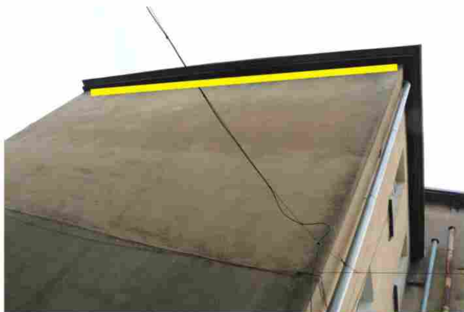
Ryc. 29. Budynek przy ul. Sienkiewicza 34 - ściana północno-wschodnia - z zaznaczeniem miejsca realizacji kompensacji. Żółta linia oznacza miejsce zawieszenia rzędu budek trocinobetonowych dla jerzyka (typ APK-2).
