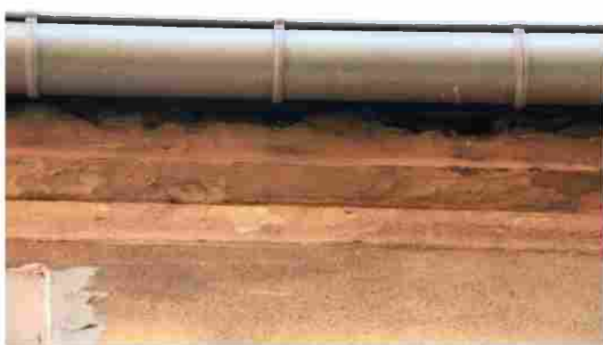
Ryc. 6. Budynek przy ul. Równoległej 11 – przykłady szczelin na łączeniu muru i dachu na elewacji zachodniej.
