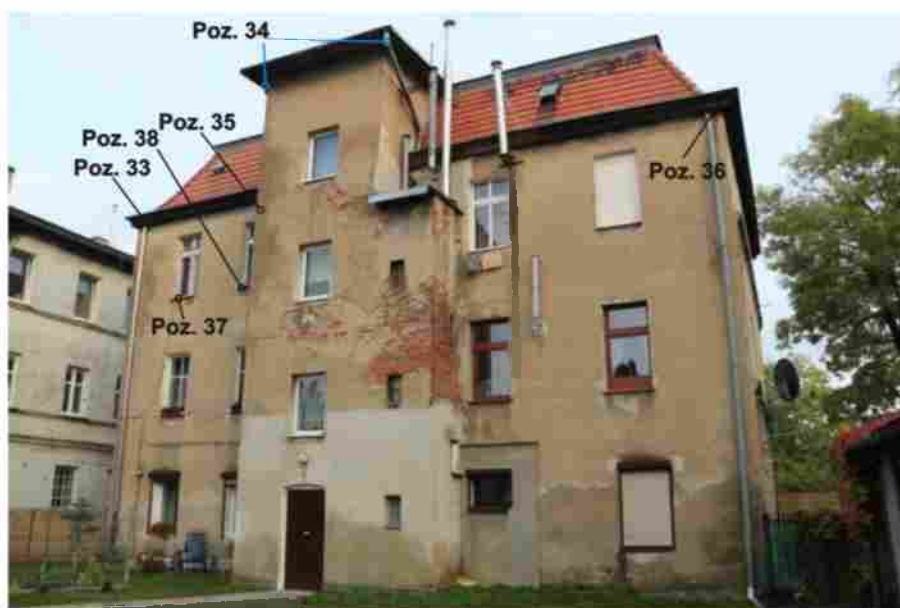
Ryc. 18. Budynek przy ul. Sienkiewicza 34 – elewacja północno-zachodnia – z zaznaczeniem pozycji stwierdzonych gniazd i siedlisk.
