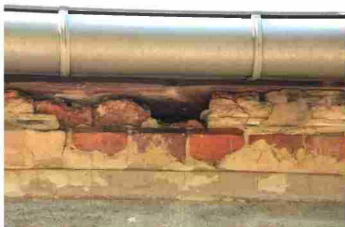
Ryc. 7. Budynek przy ul. Równoległej 11 – przykłady szczelin na łączeniu muru i dachu na elewacji wschodniej.
