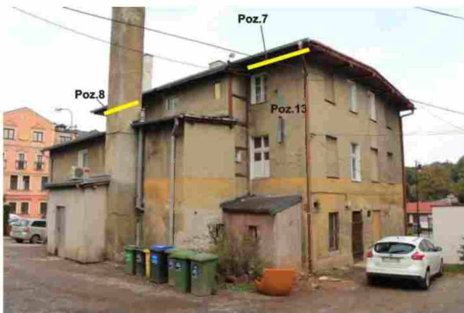
Ryc. 15. Budynek przy ul. Solickiej 2 – ściana południowa i zachodnia - z zaznaczeniem pozycji stwierdzonych gniazd i siedlisk.
