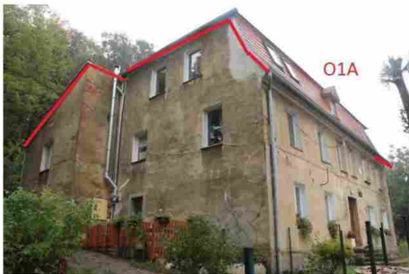
Ryc 18. Potencjalne siedliska nietoperzy w budynku przy ul. Okrężnej 3 cz2
