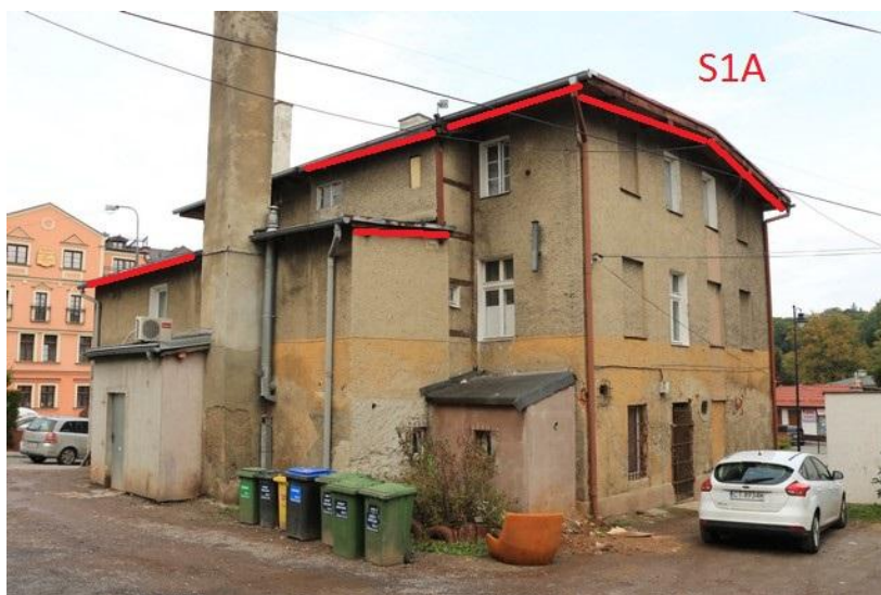
Ryc 36. Potencjalne siedliska nietoperzy w budynku przy ul. Solickiej 2 cz2
