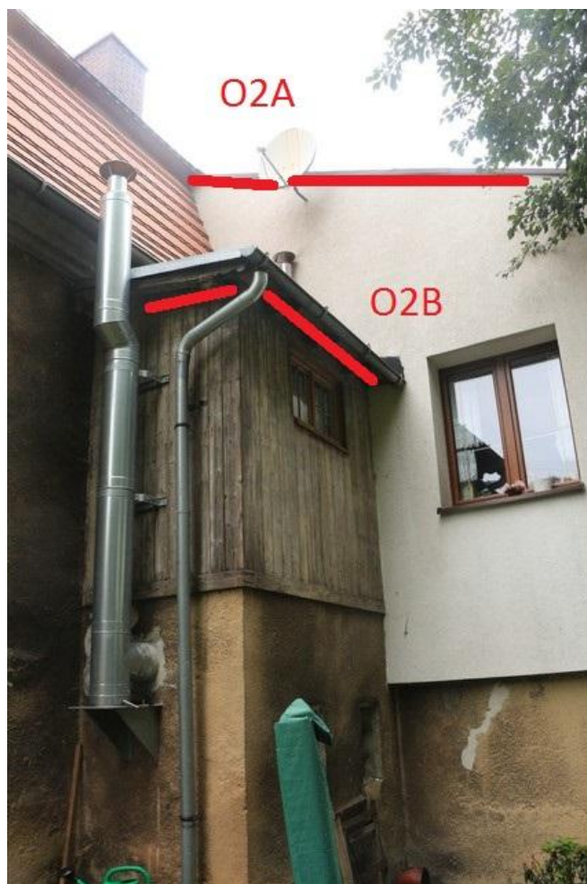
Ryc 19. Potencjalne siedliska nietoperzy w budynku przy ul. Okrężnej 3 cz3
