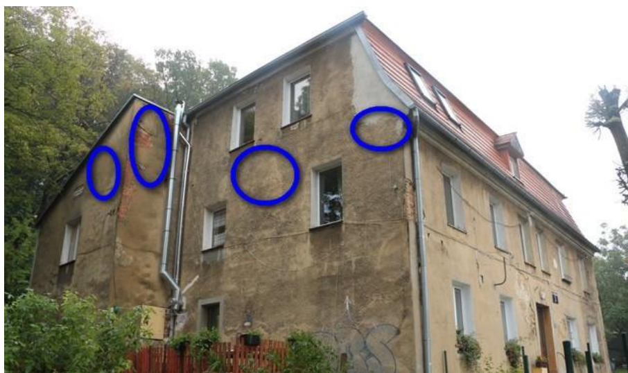
Ryc. 23. Miejsca zawieszenia budek dla jerzyków na elewacji północnej budynku przy ul. Okrężnej 3, okręgi oznaczają przykładowe miejsca zawieszenia budek.
