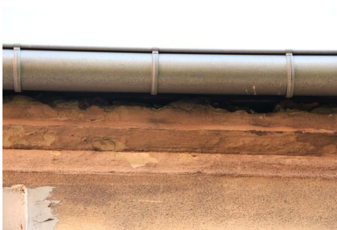
Ryc. 6. Budynek przy ul. Równoległej 11 – przykłady szczelin na łączeniu muru i dachu na elewacji zachodniej.
