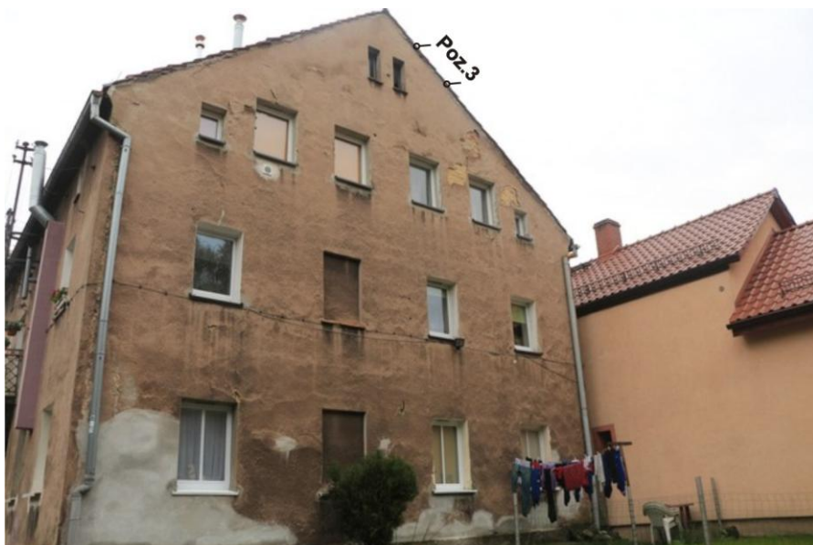
Ryc. 10. Budynek przy ul. Równoległej 12 – ściana zachodnia - z zaznaczeniem pozycji stwierdzonych gniazd i siedlisk.
