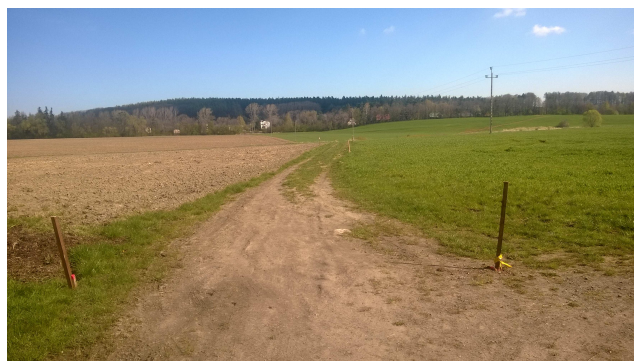
widom z hm ok. 0+00 początek opracowania – widoczna zarośnięta nawierzchnia
