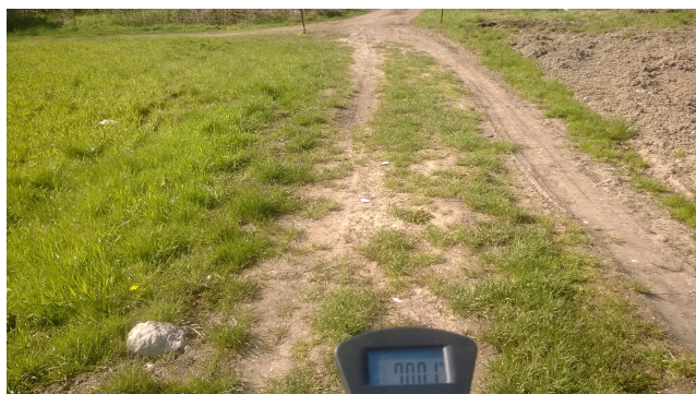
widom z hm ok. 0+73 – widoczna zarośnięta nawierzchnia drogi
