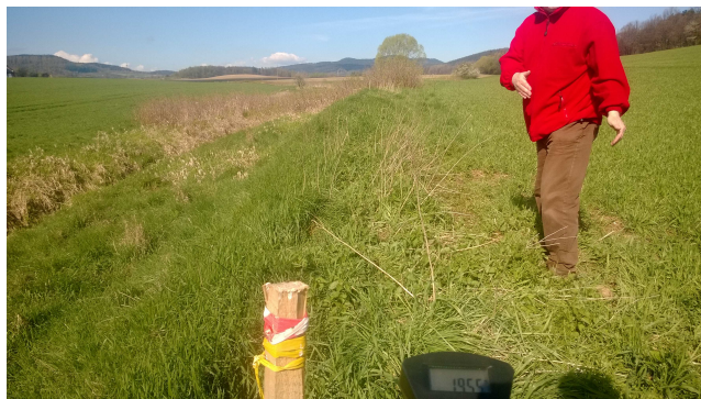
widom z hm ok. 5+78 – widoczna zarośnięta nawierzchnia drogi oraz zarośnięty rów odwadniający, skarpa uniemożliwiająca prowadzenie bezpiecznego ruchu pojazdów rolniczych
