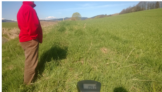
widok z hm ok. 6+00,00 - widoczna zarośnięta nawierzchnia drogi powodująca wnikanie wody opadowej w głąb konstrukcji i jej erozję
