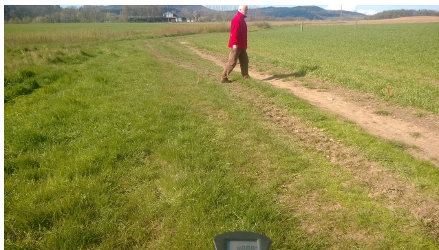
widom z hm ok. 3+73 – widoczna zarośnięta nawierzchnia drogi oraz zarośnięty rów odwadniający
