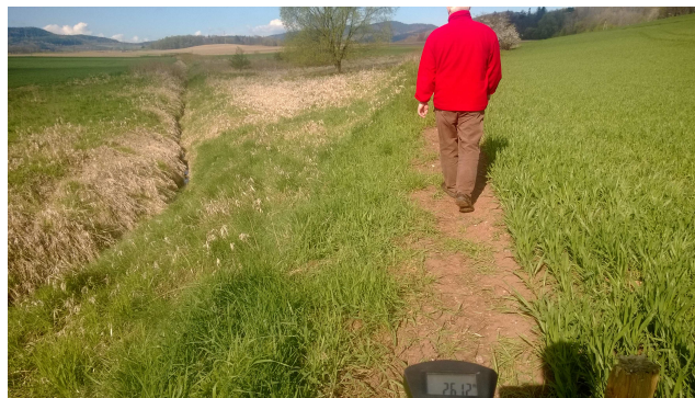
widok na drogę z hm ok. 5+12 – widoczna zarośnięta nawierzchnia drogi oraz zarośnięty rów odwadniający, skarpa uniemożliwiająca prowadzenie bezpiecznego ruchu pojazdów rolniczych
