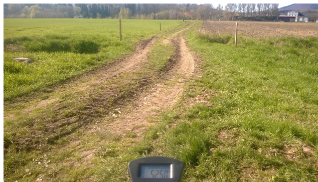
widom z hm ok. 2+48 – widoczna zarośnięta nawierzchnia
